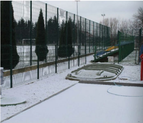
Oczyszczalnia ścieków przy Zespole Szkolno-Przedszkolnym w Nowych Piekutach
